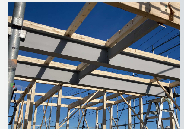
補剛材接合部
