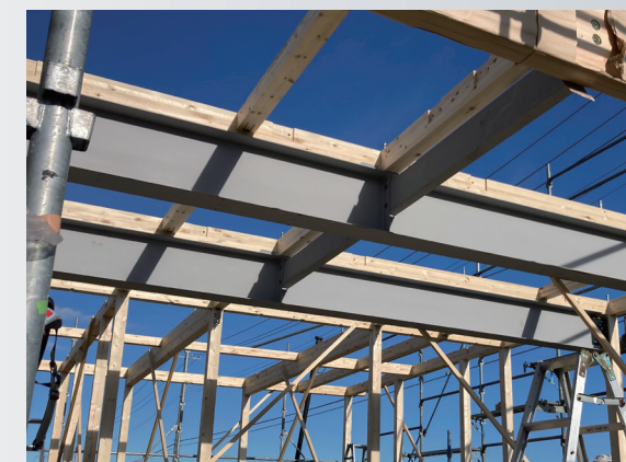
補剛材接合部
