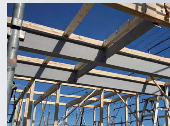
補剛材接合部
